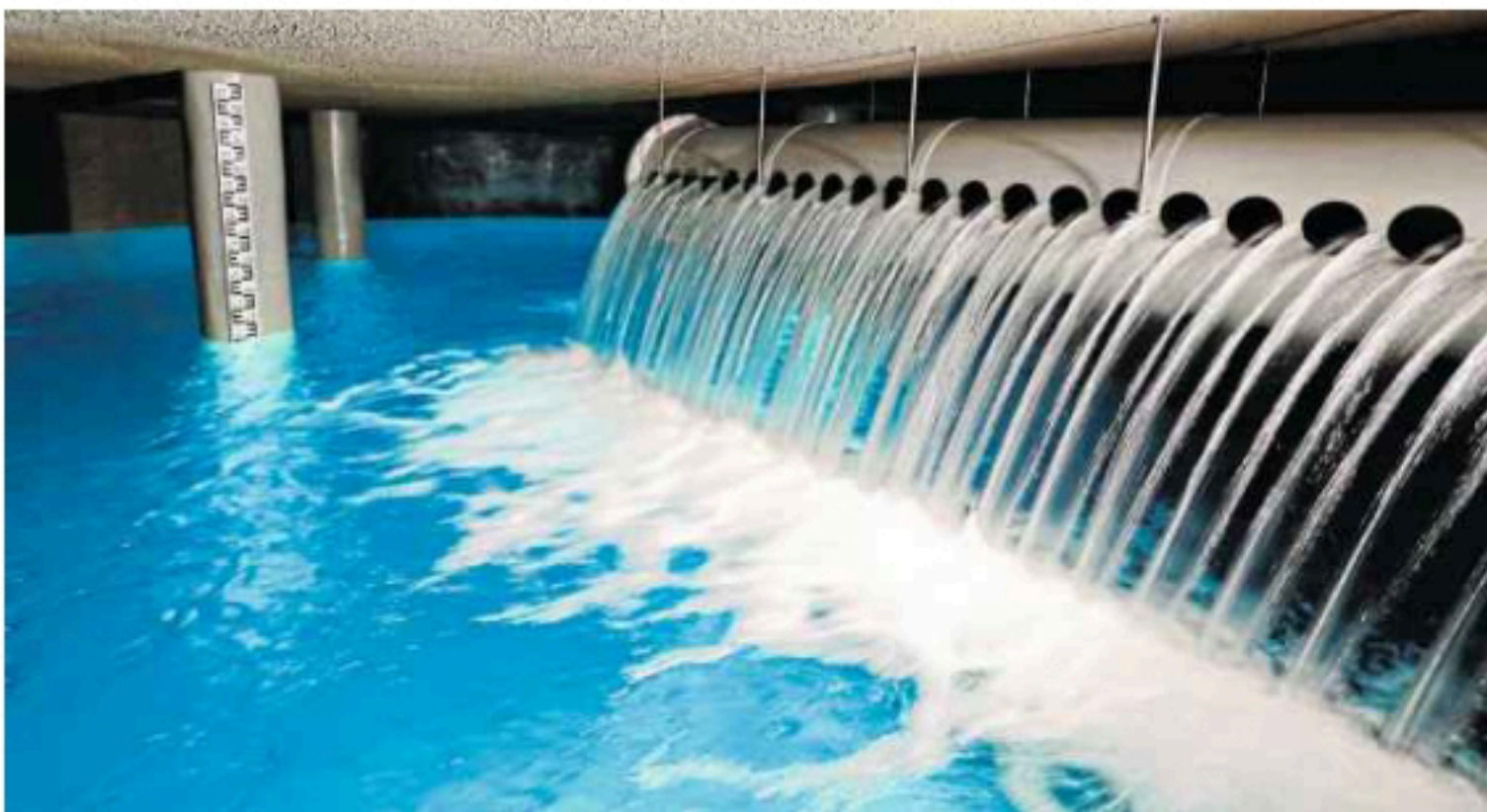
Der Zulauf in einen Trinkwasserspeicher am Wasserwerk Diebesweg.
