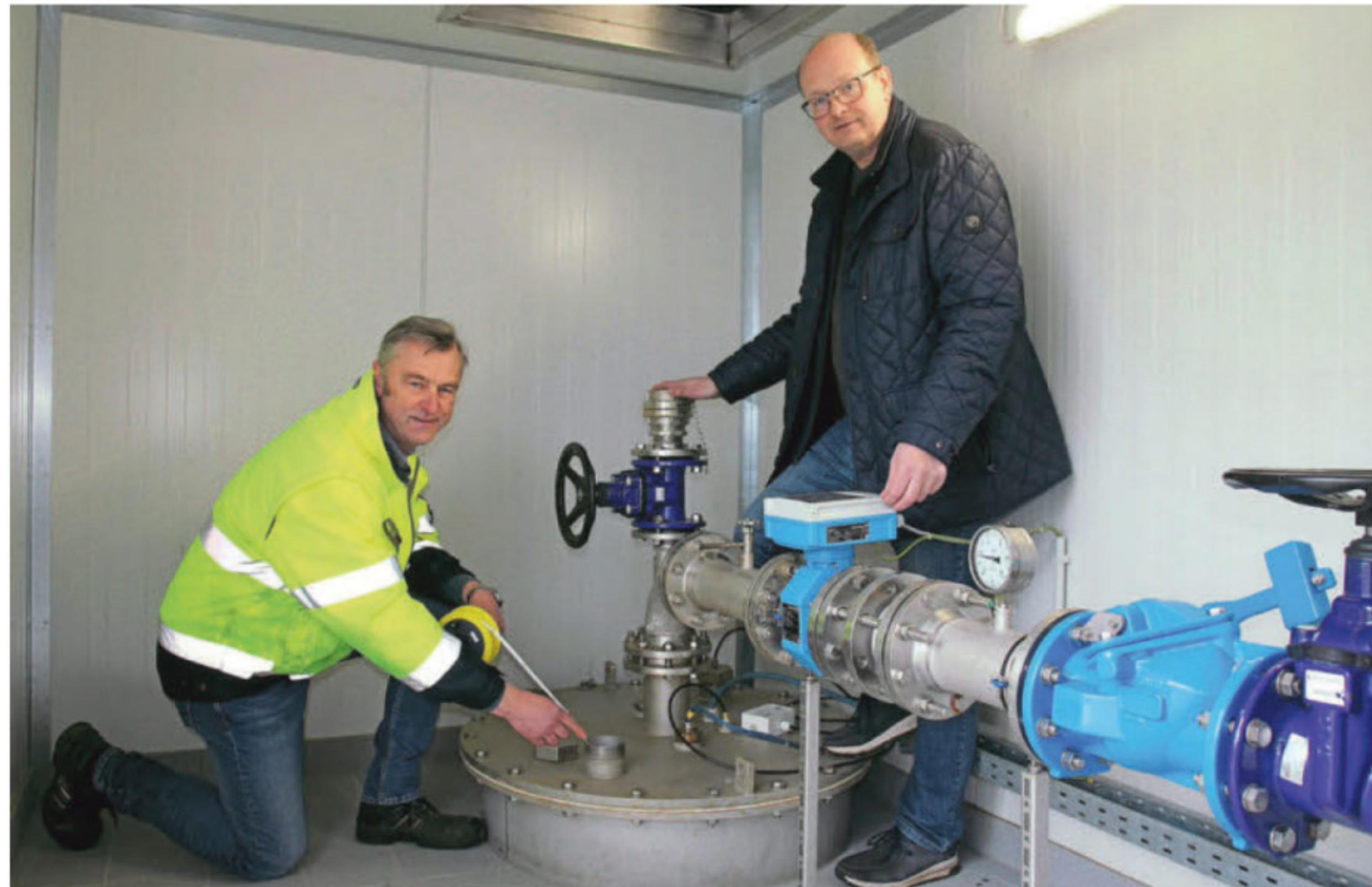
An einem von 13 Brunnen des Wasserwerks in Ostenland messen Robert Siemensmeyer (links) und Olaf Merschmann den Wasserstand. Erst im Frühjahr wurden acht der Brunnen mit einer Hochdruckspülung gereinigt und Eisenschlamm und Mangan-Ablagerungen herausgespült. Foto: Axel Langer
